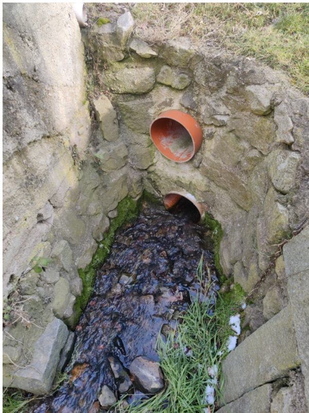
Obr. 13: Vtok do zatrubnění v Rosovicích (kritické místo)
