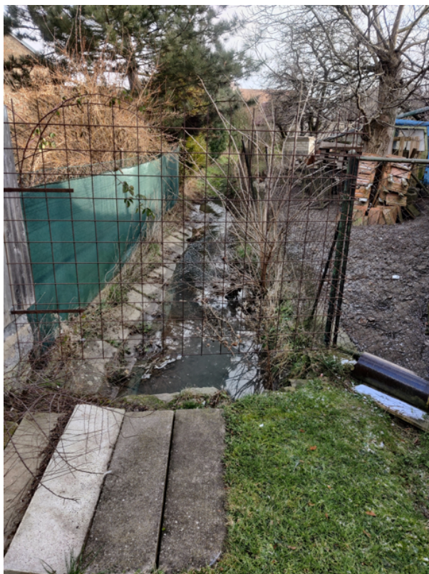
Obr. 14: Vyústění zatrubnění v Rosovicích (kritické místo)
